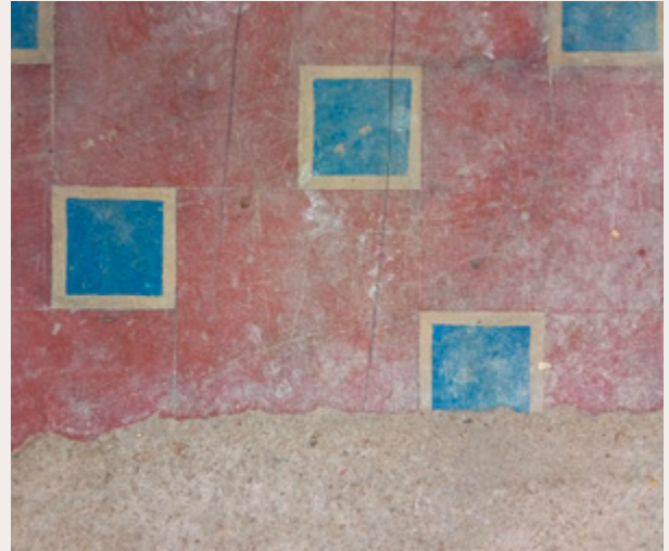
Detalles de las baldosas del piso del Gran Galpón y del arranque del parche de cemento del sector central.
